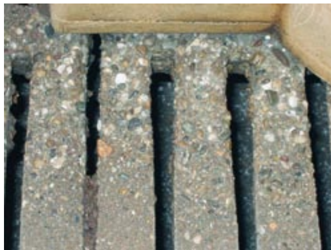
Bild 4: Chemischer Angriff bei Betonspalten in der Nähe von Futtertrögen
