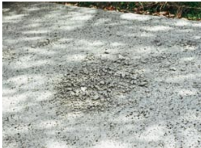
Bild 18: Örtliche Entmörtelung an einer HGTD
