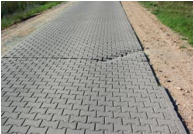
Bild 19: Pflasterschaden durch Wühltiere
