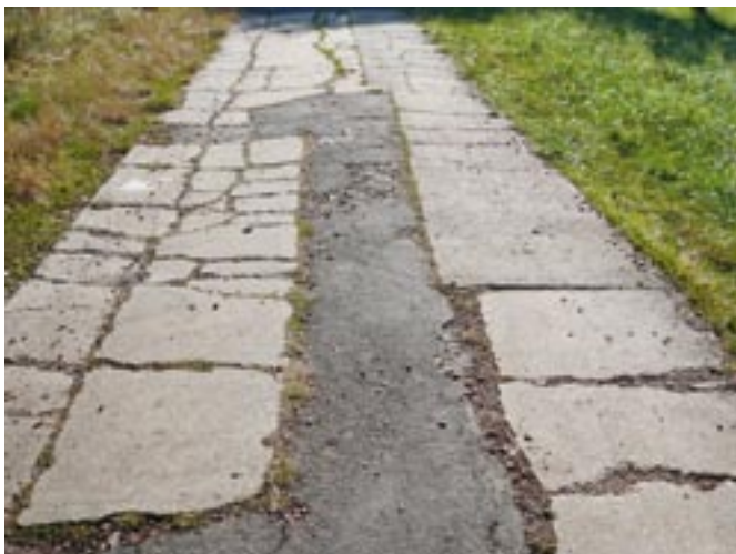
Bild 13: Unsachgemäße Erhaltungsmaßnahme mit Asphalt
