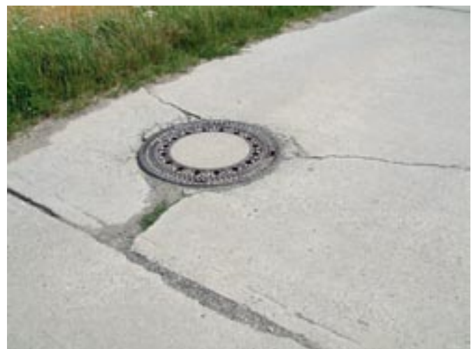
Bild 10: Risse infolge falscher Anordnung an einem Schacht
