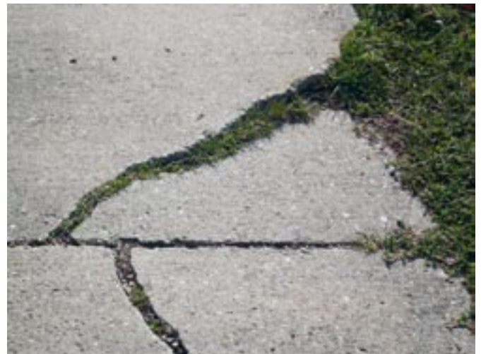
Bild 8: Eckabbruch mit Absackung
