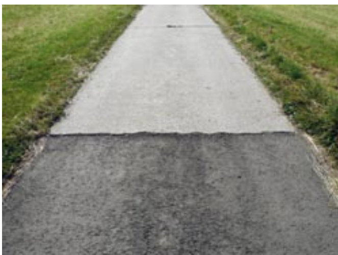
Bild 15: Absackung einer eingefügten Asphaltfläche
