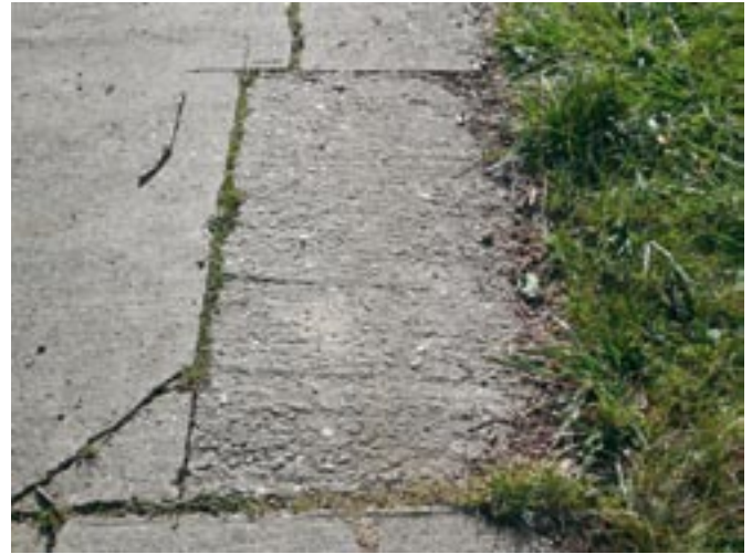
Bild 12: Unsachgemäße Erhaltungsmaßnahme mit Beton
