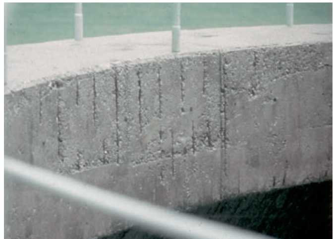
Bild 4: Betonabplatzungen und Bewehrungskorrosion durch zu geringe Betondeckung
