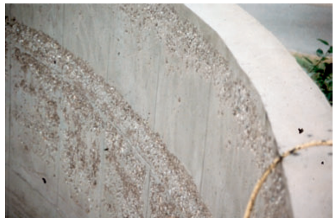
Bild 1: Betonabplatzungen durch Verwendung nicht frostbeständiger Gesteinskörnungen in der Wasserwechselzone der Behälterwand
