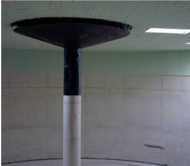
Bild 6: Beschichtung und Wärmedämmung im Fermentergasraum
