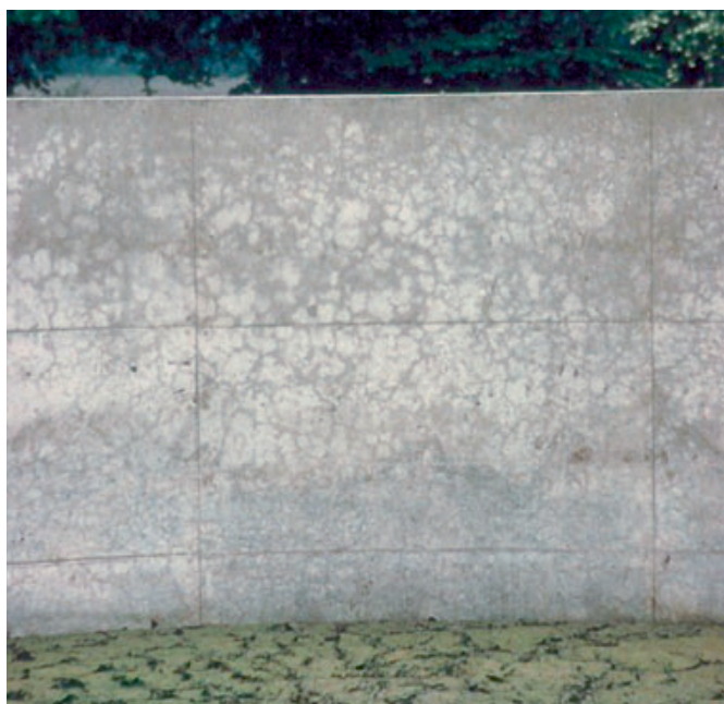
Bild 2: Rissbildungen durch alkaliempfindliche Gesteinskörnungen (AKR) in einer Behälterwand
