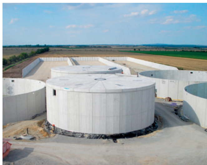
Bild 6: Fermenter mit werkseitig eingebauten Rührwerkslagern
