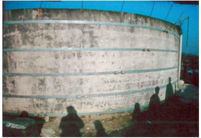
Bild 12: Sicherung eines Güllebehälters mit Rissen durch Anbringen einer Vorspannung mit Spannringen
