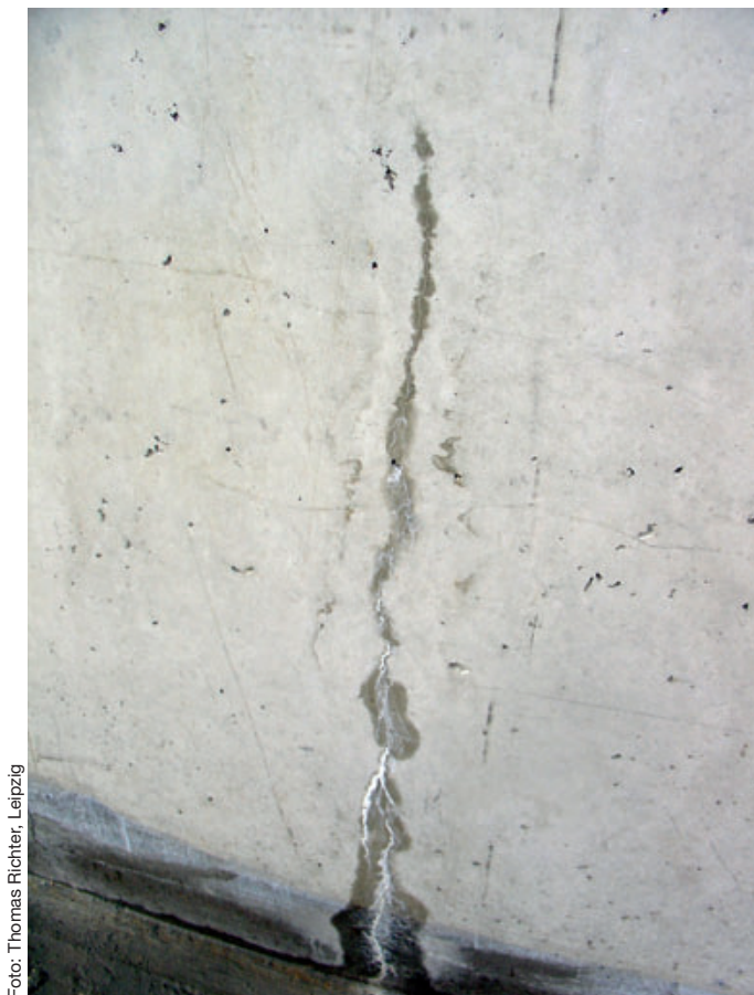
Bild 8: Durchfeuchteter Riss bei Wasserfüllung eines Güllebehälters während der Selbstheilung
