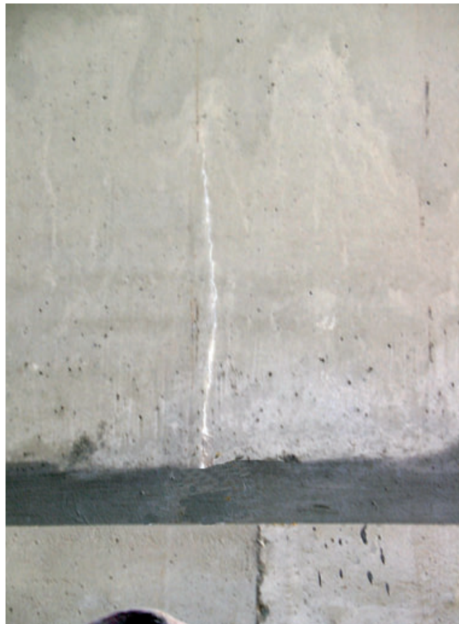
Bild 9: Dichter Riss nach Abschluss der Selbstheilung
