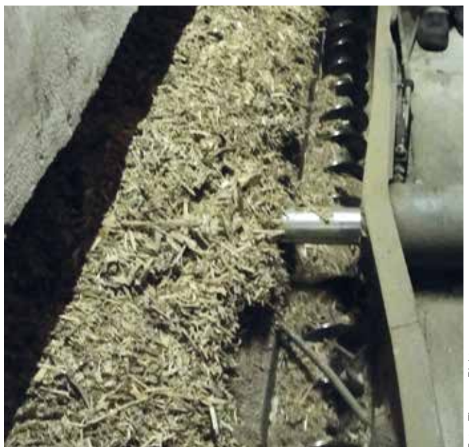
Bild 21: Kesselbeschickung über Zellradschleuse
