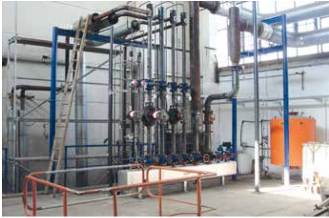
Bild 15: Verteilung für das Nahwärmenetz
