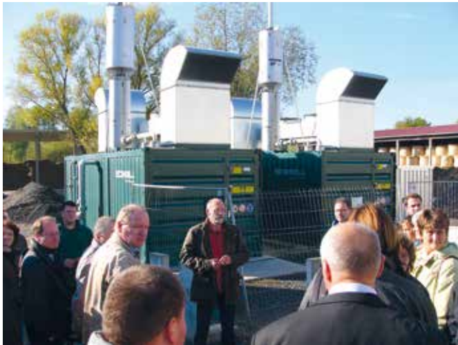
Bild 2: Zwei „flüsterleise“ Blockheizkraftwerke in Schlöben
