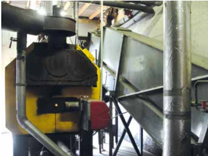
Bild 18: Biomasseheizkessel mit redundantem Ölbrenner
