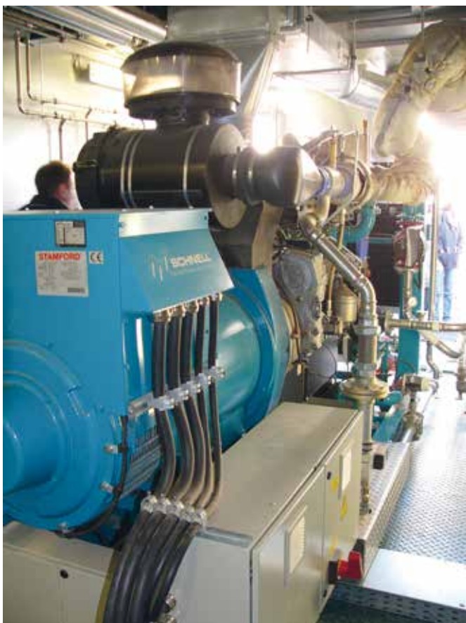
Bild 3: Zündstrahl-BHKW (265 kW el ) im schalldichten Container
