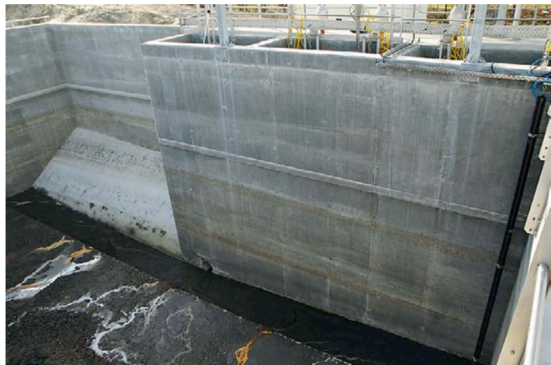
Bild 1: Fertiggestellte Pumpenkammer im Betrieb
