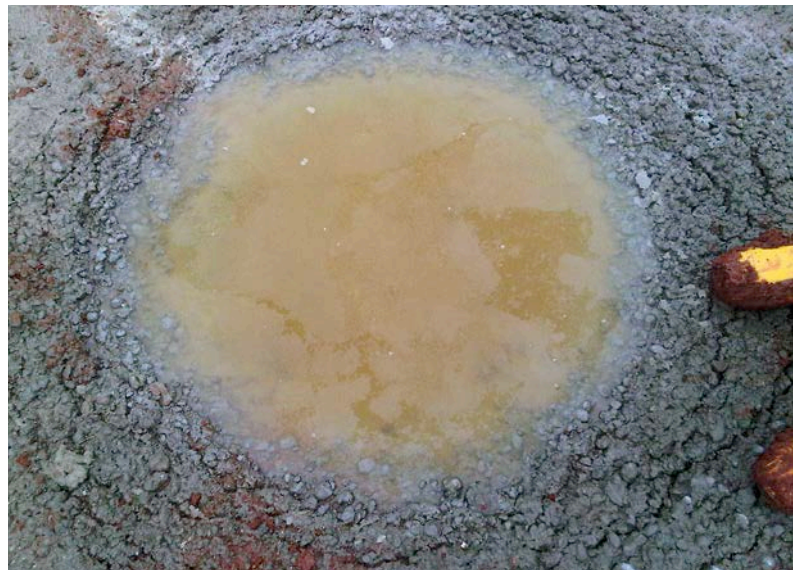
Bild 2: Bluten des Betons bei einem Gründungspfahl
