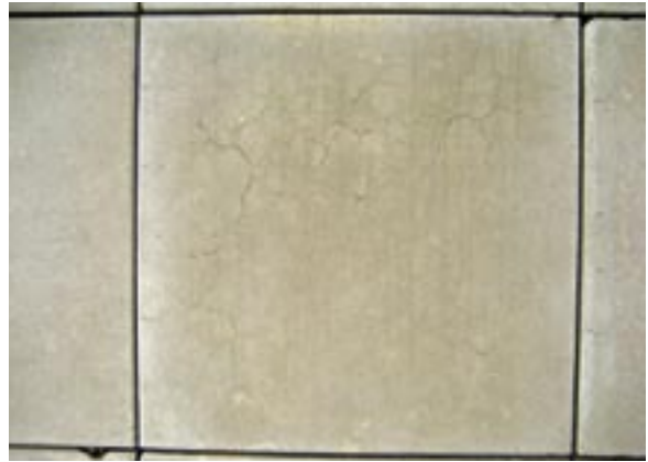
Bild 6: Plattenbelag mit beginnender AKR-Schädigung und Gelb-/Braunverfärbung
