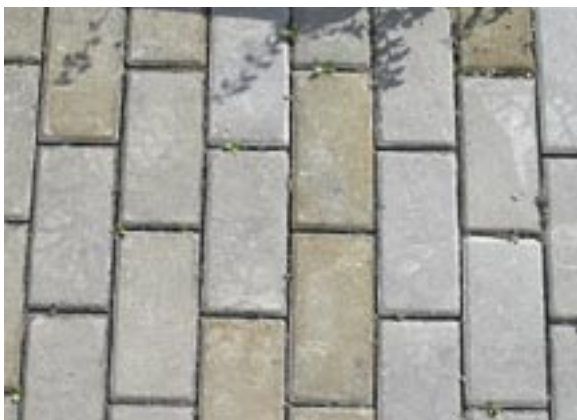
Bild 3: Nach der Verlegung aufgetretene Gelb-/Braunverfärbungen
