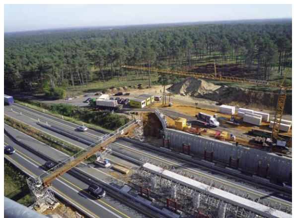
Bild 7: Blick vom Kran auf den Mittelquerträger, ein Widerlager sowie die provisorische Fußgängerbrücke
