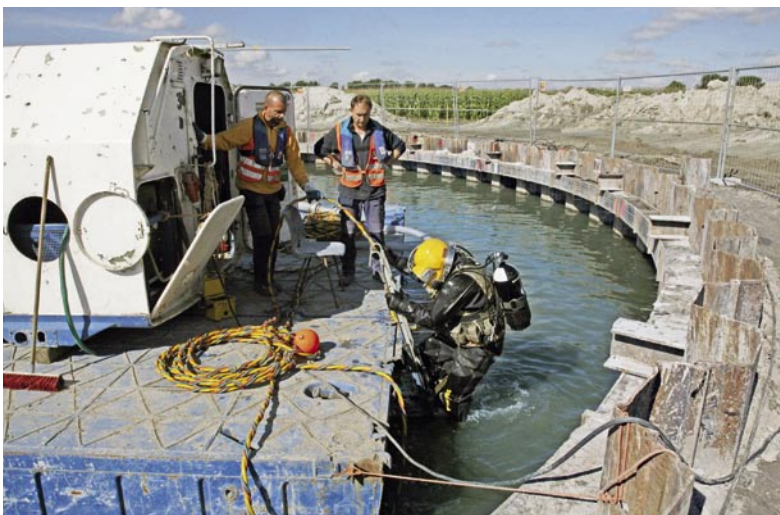
Bild 5: Aufgrund des hohen Grundwasserstands waren vor und während der Betonage Taucherkolonnen im Einsatz
