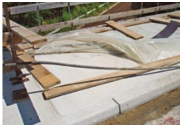
Bild 8: Nicht fachgerechte Nachbehandlung einer Brückenkappe
