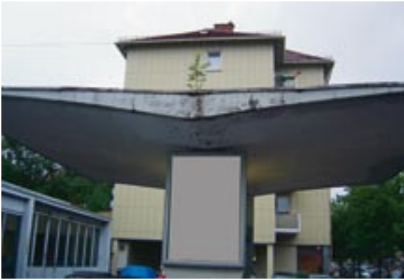
Bild 10: Wurzeln durch Bewuchs und zeitweise eindringendes Wasser führten zum Verlust der Dauerhaftigkeit.
