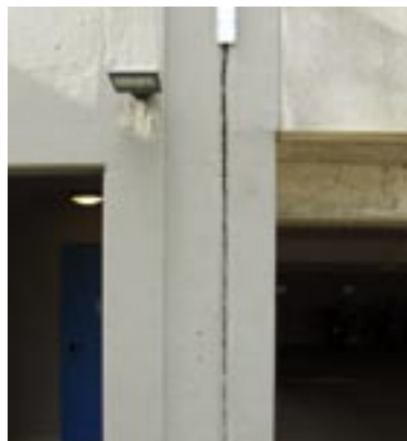
Bild 15: Öffnung der Bauwerksfuge durch temperaturbedingte Bauteilverkürzung
