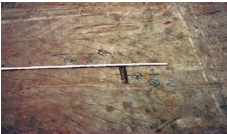
Bild 6: Diagonal gerichtete Risse mit einer Breite bis zu 5 mm
