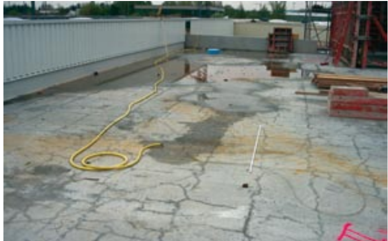
Bild 5: Rissbildung durch zu späte und falsche Nachbehandlung
