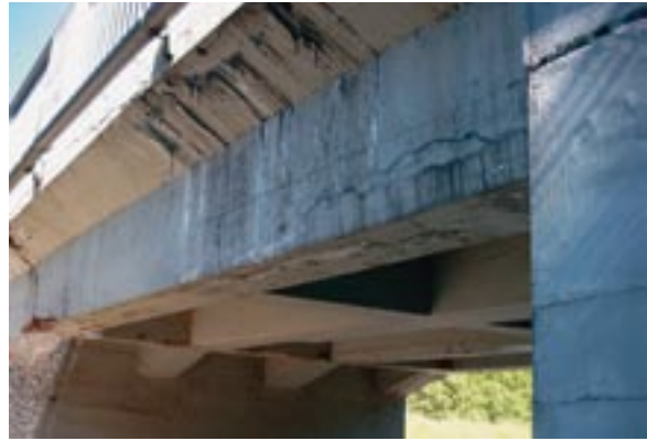
Bild 11: Gefährdung der Standsicherheit durch Längsrisse im Bereich der Trägerlängsbewehrung
