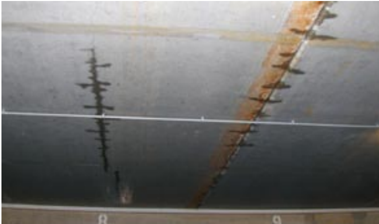
Bild 14: Wasserführende Trennrisse in der Decke des Parkdecks
