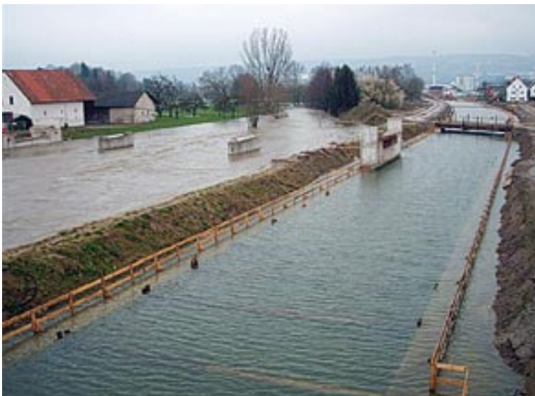
Bild 1: Hochwassersituation, überflutete Baugrube
