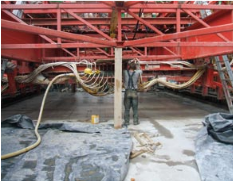
Bild 10: Steuereinheit der Außenrüttler
