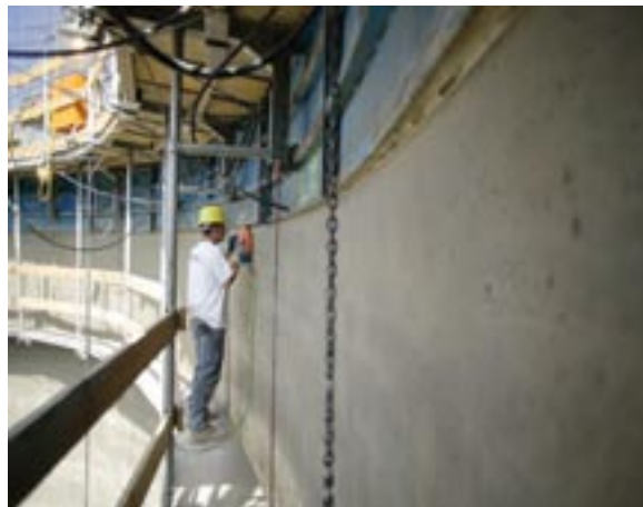
Bild 14: Trotzdem ist der Beton noch abreibbar.
