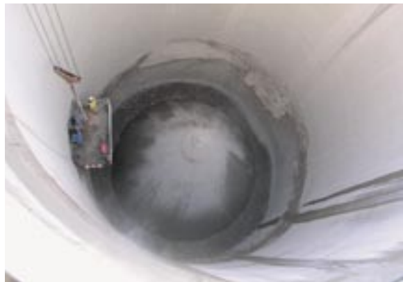
Bild 3: ... und Zerstörung des Betonrings am Silofuß - von oben ...
