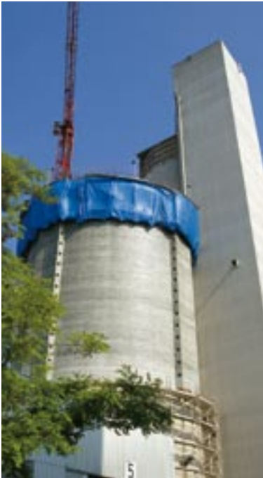
Bild 11: Gleiten des vorgespannten Silos 7
