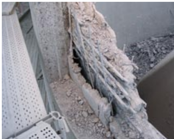
Bild 5: Schalenförmige Abplatzung der Betonüberdeckung am Innenzylinder
