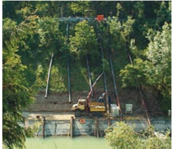
Bild 13: Eine der Pumpstationen zum Entleeren des Kanals
