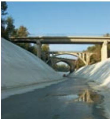
Bild 4: Böschung, Sohle und Brücken vor der Instandsetzung
