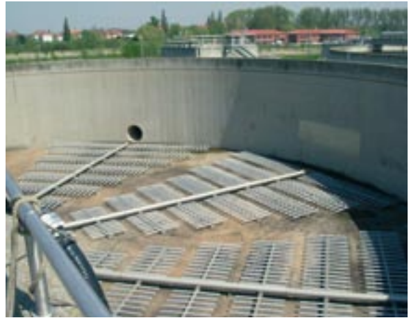
Bild 11: Belüftungskerzen im Belebungsbecken 4 (Wittenberg)
