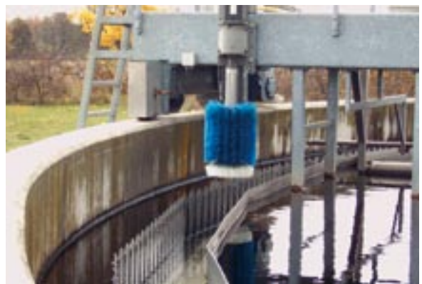
Bild 18: Detail Räumeraufbahn und Räumerbücke über Nachklärbecken 2 (Coswig)
