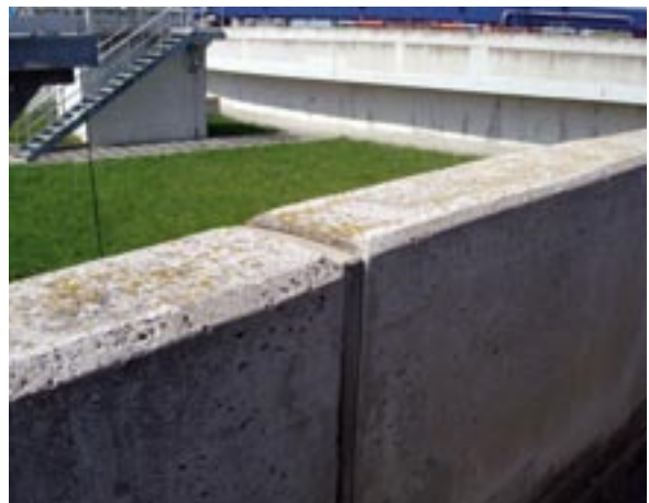
Bild 9: Dehnungsfuge Nachklärbecken 2 (Wittenberg)
