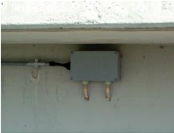
Bild 3: Kabelzuführung für die Oberflächenheizung der Räumlerlaufbahn des Nachklärbeckens (Wittenberg)
