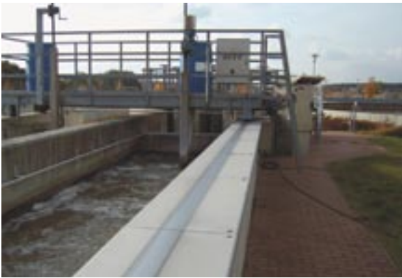
Bild 19: Sandfang mit Räumlerlaufbahn und Edelstahlauflage (Coswig)
