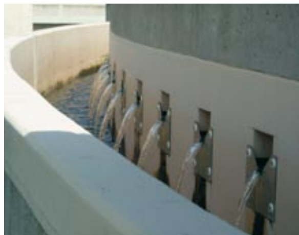
Bild 5: Detail Überlaufgerinne Nachklärbecken 3 (Wittenberg)
