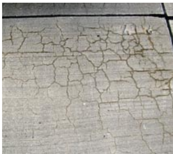
Bild 2: Infolge ARK geschädigte Betonfahrbahndecke mit netzförmiger Rissbildung
