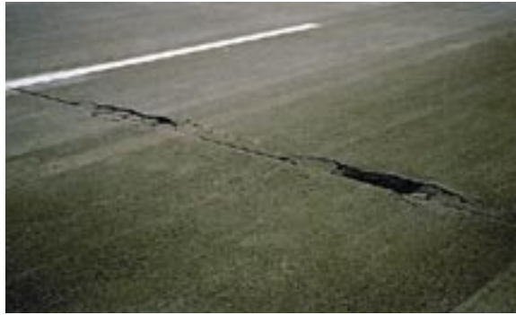
Bild 3: Verkehrsgefährdende Kantenausbrüche im Fugenbereich einer Betonfahrbahndecke, die durch AKR geschädigt wurde
