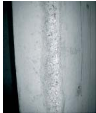
Bild 9b: Zementleimaustritt durch unzureichende Abdichtung
