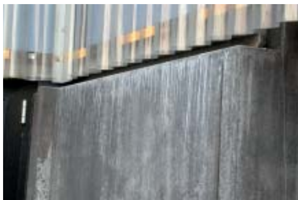
Bild 1: Verfärbungen an der Betonoberfläche durch fehlerhafte Entwässerungsführung
