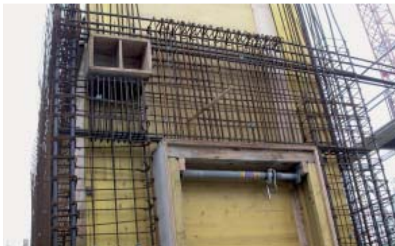
Bild 8: Dicht liegende Bewehrung um Aussparung, die eine Verdichtung mit dem Innenrüttler ausschließt
