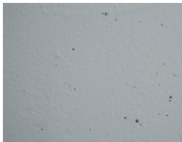
Bild 10: Grün beschichteter Pfeiler im Eingangsbereich
