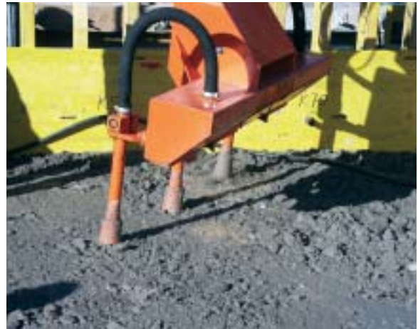
Bild 5: Einbau und Verdichtung des Betons mit Rüttelflaschen, die ein Kettendozer an einer Traverse führt
