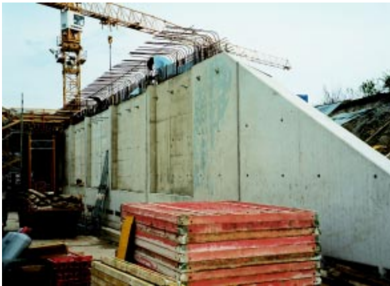
Bild 15: Rechte Flügelwand der Einhausung Nord mit der typischen Blaufärbung von Beton mit Hochfenzement
