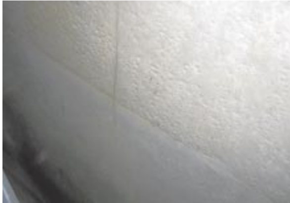
Bild 6: Negativabdrücke der Blasen in der Betonoberfläche nach dem Betonieren
