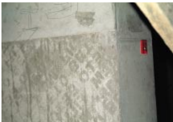
Bild 8: Die Firmenbezeichnung auf der Schaltafel ist als Negativabdruck auf der Betonoberfläche sichtbar.
