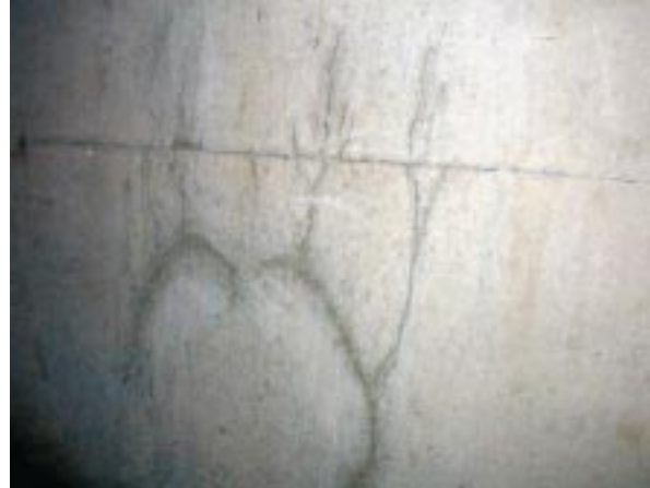
Bild 16: Graue Ablaufspuren auf der Oberfläche
