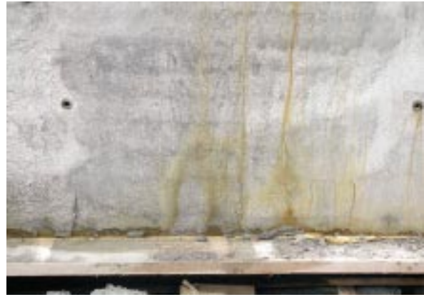
Bild 4: Verstärkte Braunfärbungen am Fußpunkt der Wand
