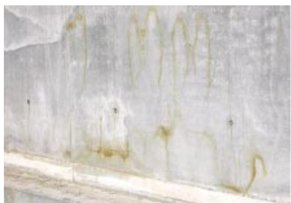
Bild 14: Braunverfärbung an Wandfläche und Fußpunkt
