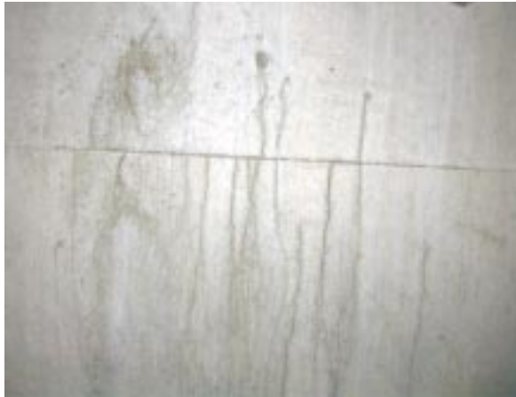
Bild 15: Graue Ablaufspuren auf der Oberfläche
