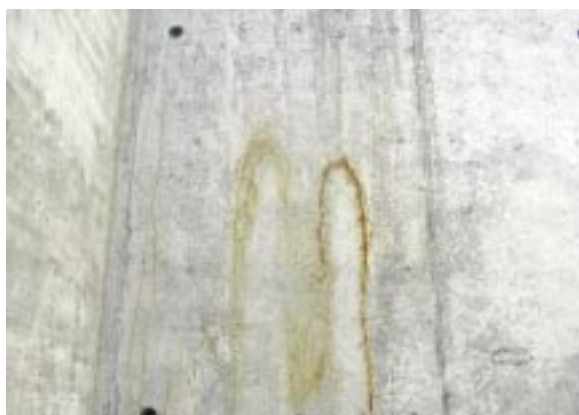
Bild 1: Typische Braunverfärbung an einer Sichtbetonfläche
