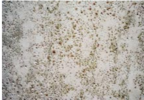
Bild 7: Vertiefungen in der Sichtbetonoberfläche mit brauner Färbung
