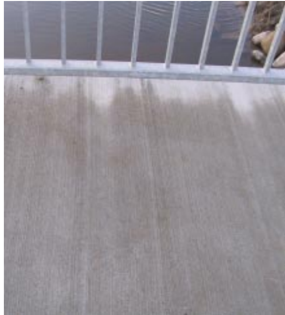
Bild 10: „Brücke R“ – Brückenkappe Ost, hergestellt mit CEM I, nach dem ersten Winter 2001/02
