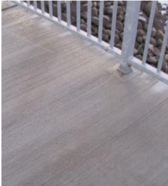
Bild 9: „Brücke R“ – Brückenkappe West, hergestellt mit CEM II/B-S, nach dem ersten Winter 2001/02
