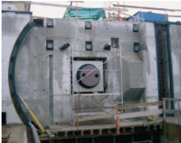
Bild 15: Torlamelle Oberhaupt; Zweitbetonbereiche für das Zugsegmenttor sind bewehrt und werden später ausbetoniert (größere Genauigkeitsanforderungen)
